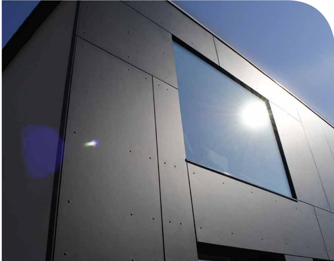
Dunkle Fassadenplatten an der Ost- und Westfassade charakterisieren die äußere Erscheinung und fördern die Energiegewinnung.
